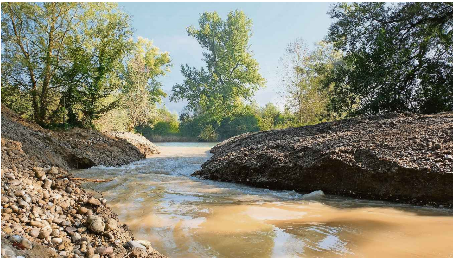
Hier fliesst der neue Nebenfluss in die Limmat. Bis gestern Vormittag war hier noch ein Kiesdamm dem Wasser im Weg gestanden.
